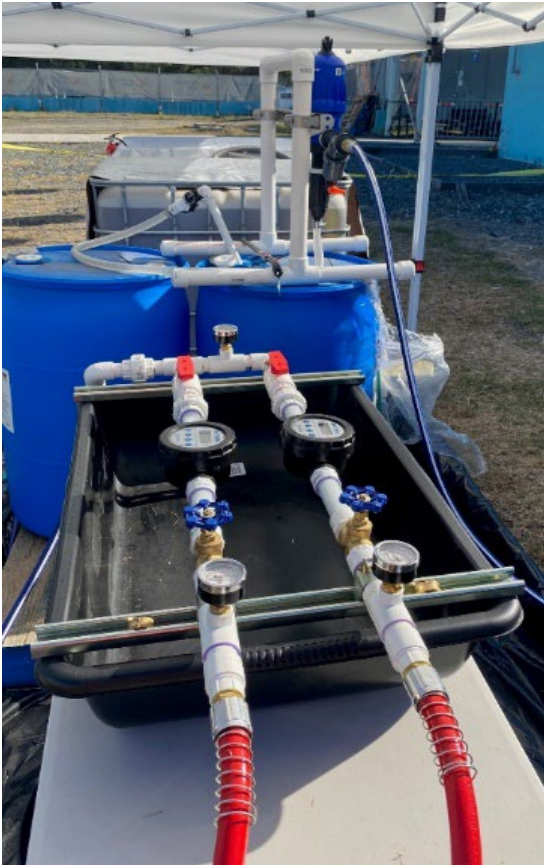
Colector de Inyección y Dosatron
