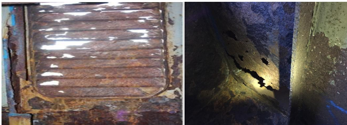
Ilustracja 28. Zdjęcia zrobione przez Podróżujących Kontrolerów Straży Przybrzeżnej podczas wizyty przy EL YUNQUE w Tacomie w stanie Waszyngton w październiku 2016 r. pokazujące przykłady korozji w szwach wentylacyjnych statku. (Zdjęcia Straży Przybrzeżnej Stanów Zjednoczonych)
